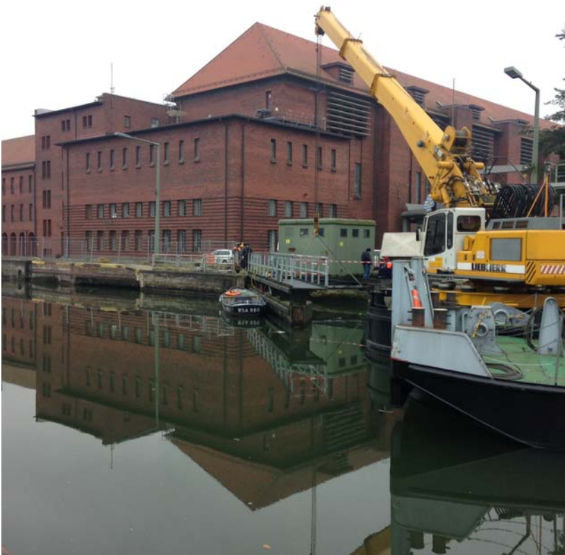
Foto 2: rechter Torflügel in der Südkammer kann nicht mehr gefahren werden
